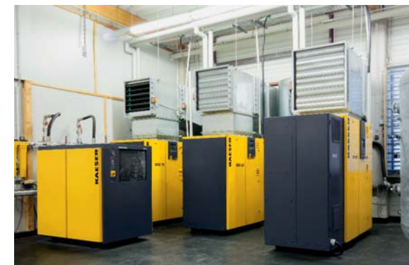
La stazione d'aria compressa è "cresciuta" con l'espansione dell'azienda
