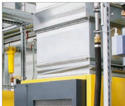
Fig. 2: Raccordo di aerazione del compressore con giunto di tela olona
