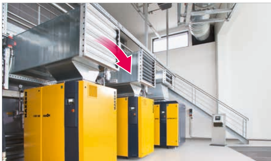
Fig. 3: Stazione d'aria compressa con sistema di aerazione a controllo termostatico
