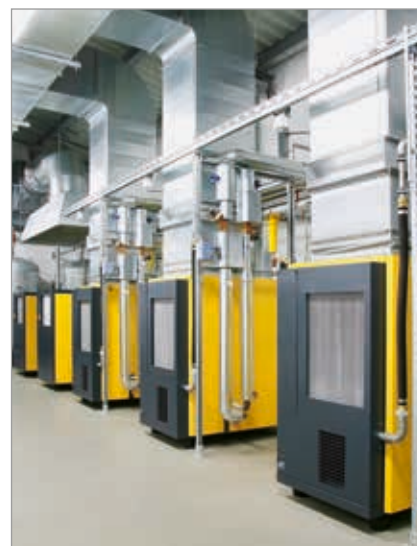
Fig. 3: Corretto allacciamento dei compressori a un sistema di recupero del calore
