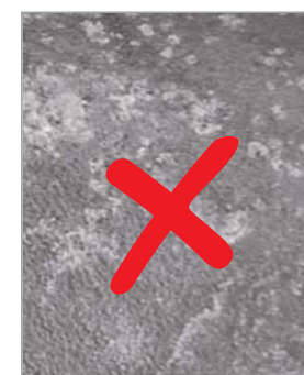
Rivestimento semplice: corrosione
