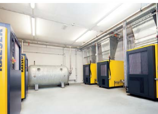
La moderna stazione d'aria compressa è installata direttamente all'interno del padiglione di produzione delle superfici dei tamburi.
