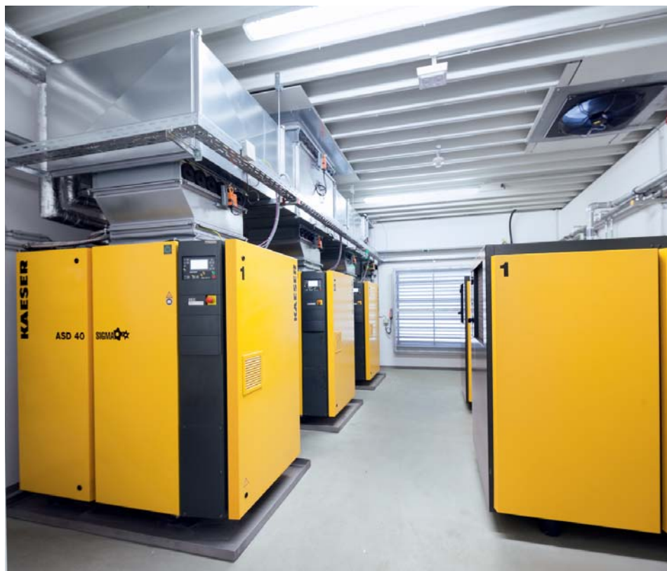
CP Autosport risparmia energia e denaro grazie al contracting di fornitura d'aria compressa
