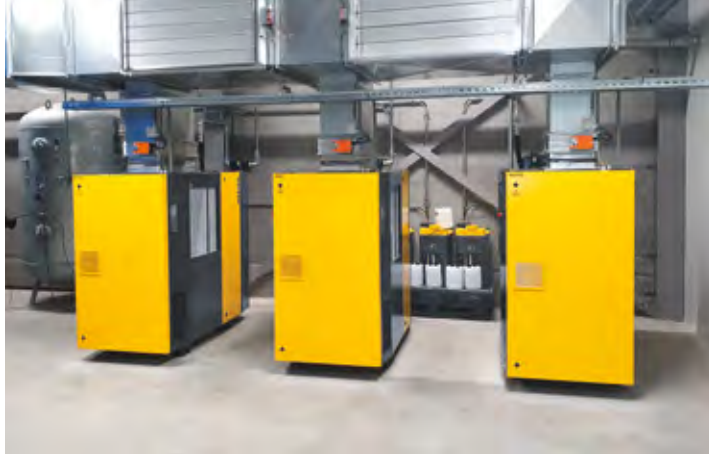
Compressori a vite KAESER ASD 40 T con sistema di recupero di calore.
