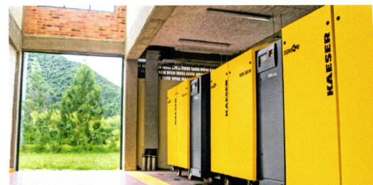
La stazione dopo l'ottimizzazione
