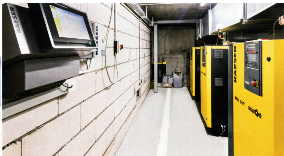
L'ultramoderna stazione di compressori viene monitorata dal master controller SIGMA AIR MANAGER 4.0
