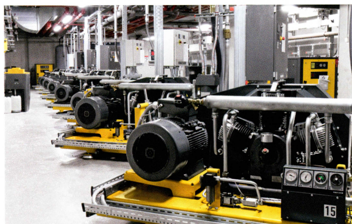
In alto: stazione pneumatica a 10 bar con soffianti a vite In basso: stazione pneumatica a 45-bar con booster
