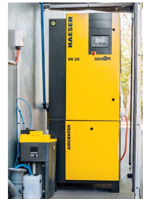
Bright Print ha deciso di sostituire un compressore obsoleto con un nuovo AIRCENTER SK 25 KAESER
