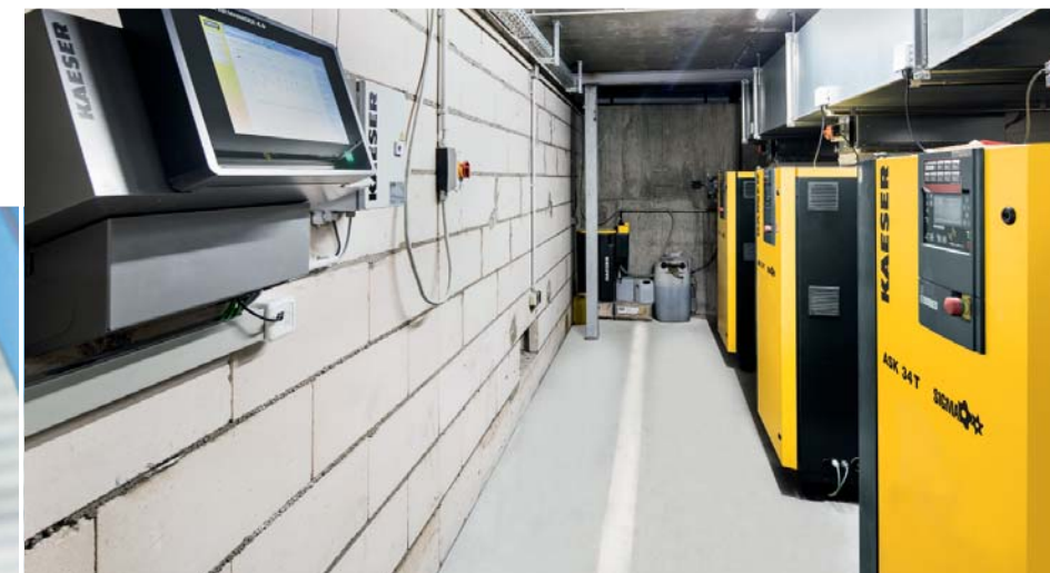
L’ultramoderna stazione di compressori viene monitorata dal master controller SIGMA AIR MANAGER 4.0
