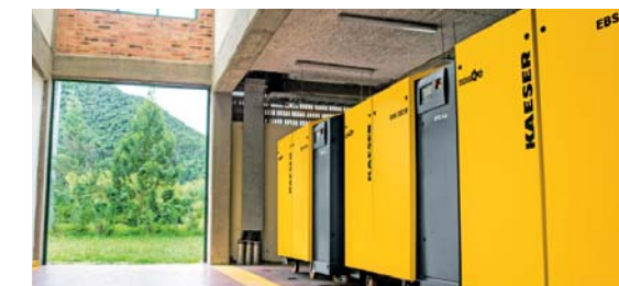
La stazione dopo l'ottimizzazione
