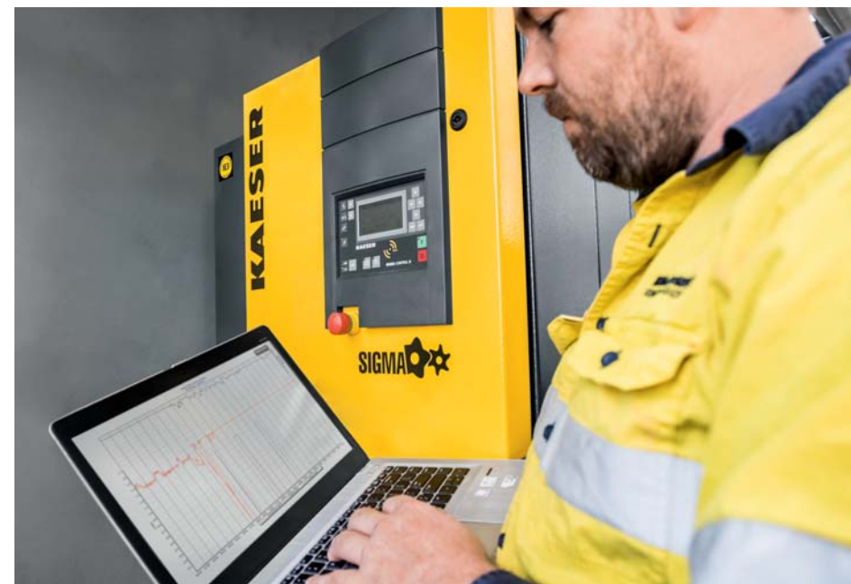
KAESER era stata incaricata di effettuare un'analisi ADA di tutta la stazione di compressori esistente
