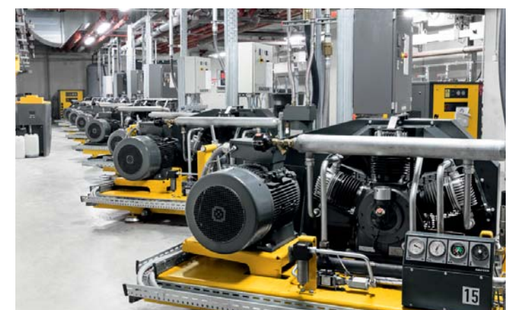
In alto: stazione pneumatica a 10 bar con soffianti a vite In basso: stazione pneumatica a 45-bar con booster
