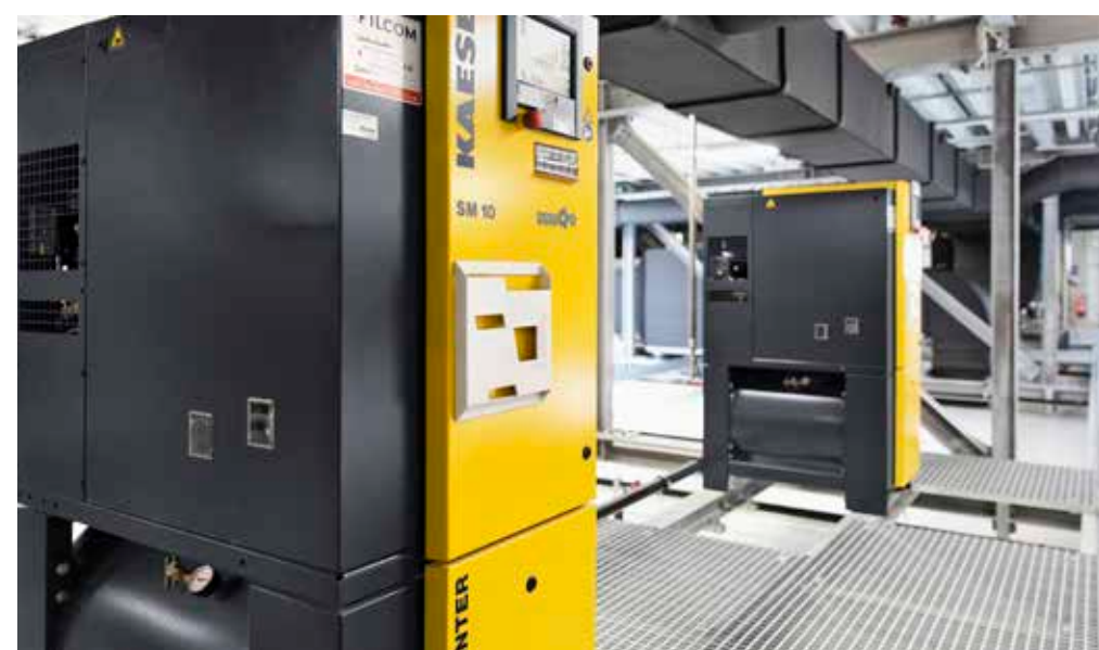
Per il nuovo centro logistico vengono utilizzate due AIRCENTER.
