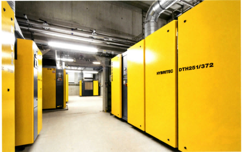
La nuova stazione di aria compressa comprende anche un moderno essiccatore combinato HYBRITEC.
