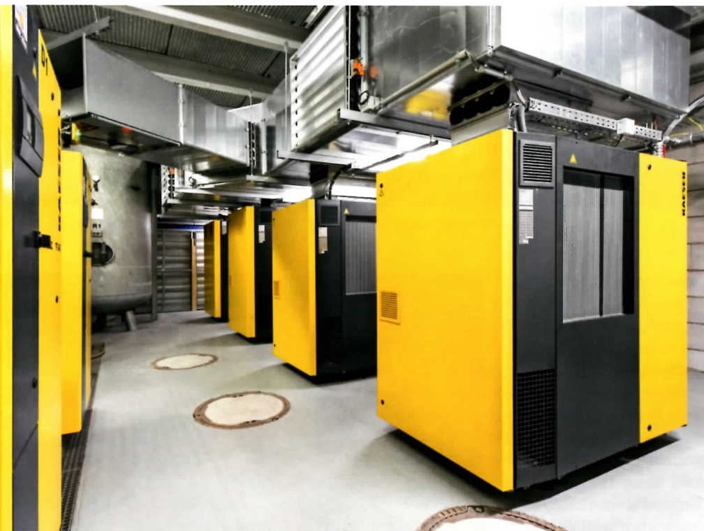
La stazione d'aria compressa con i compressori a vite KAESER.
