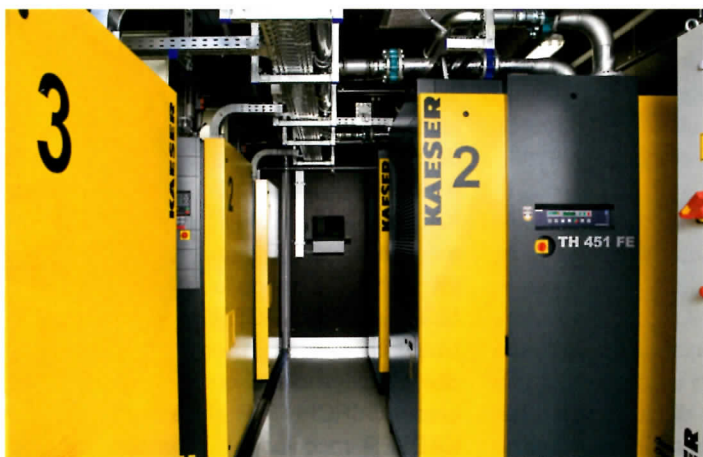
Grazie all'adattabilità dei componenti KAESER, è stato possibile ampliare più volte la stazione senza problemi.
