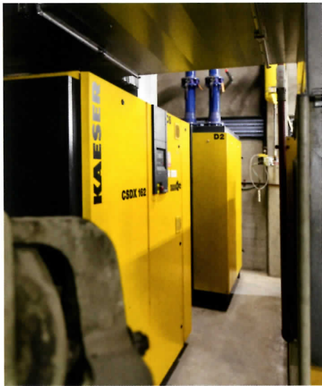
Parte della vecchia stazione di aria compressa. Qui viene convogliata l'aria compressa che deve essere particolarmente secca.
