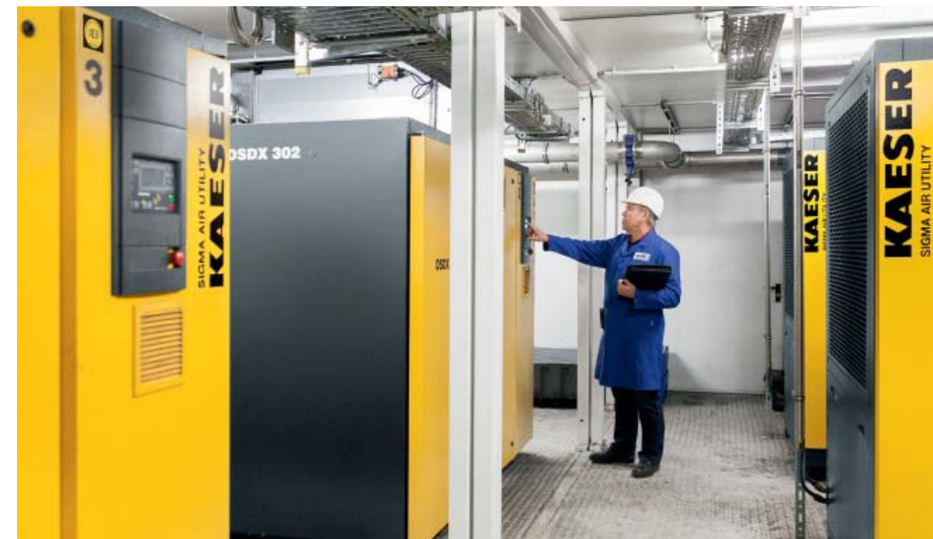
Soluzione salvaspazio: stazione KAESER in container
